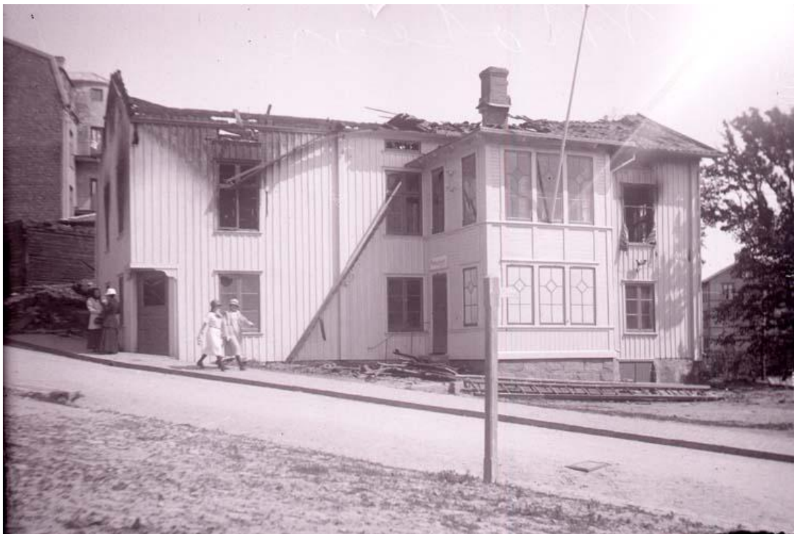
1921-06-.. Hugo Hallgren fotograferar det brandskadade huset på Kungsgatan 10. Bilden är troligen tagen bara några dagar efter branden.
